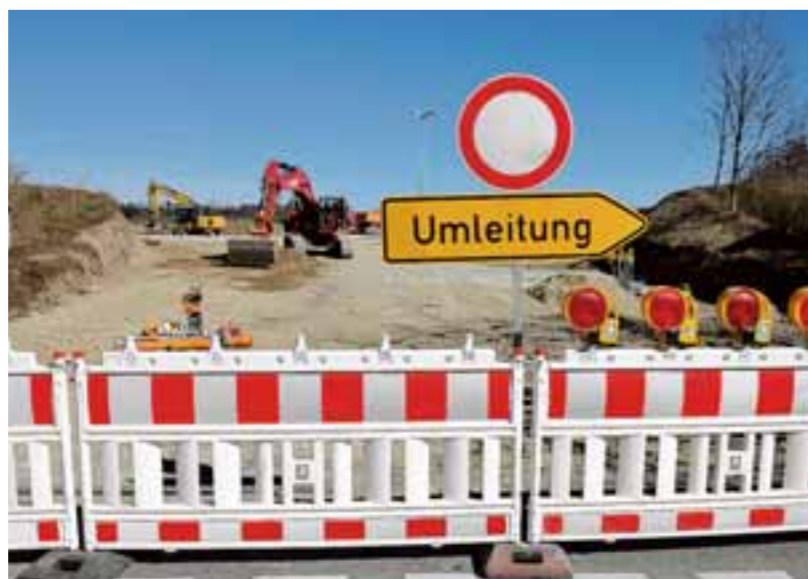
An der alten B 17 entsteht in Kaufering, Höhe Kolpingstraße, ein Kreisverkehr, der das neue Baugbiet Lechfeldwiesen IV anbindet.
